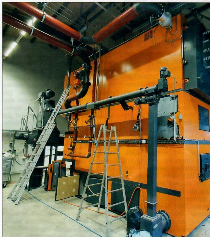
Der 2400-kWh-Holzsnitzel-Feuerungsofen konnte diesen Sommer ebenfalls in die bestehende Lastwagen-Garage der ehemaligen Mühlemann Transport gebaut und installiert werden (Foto kurz vor Inbetriebnahme).
